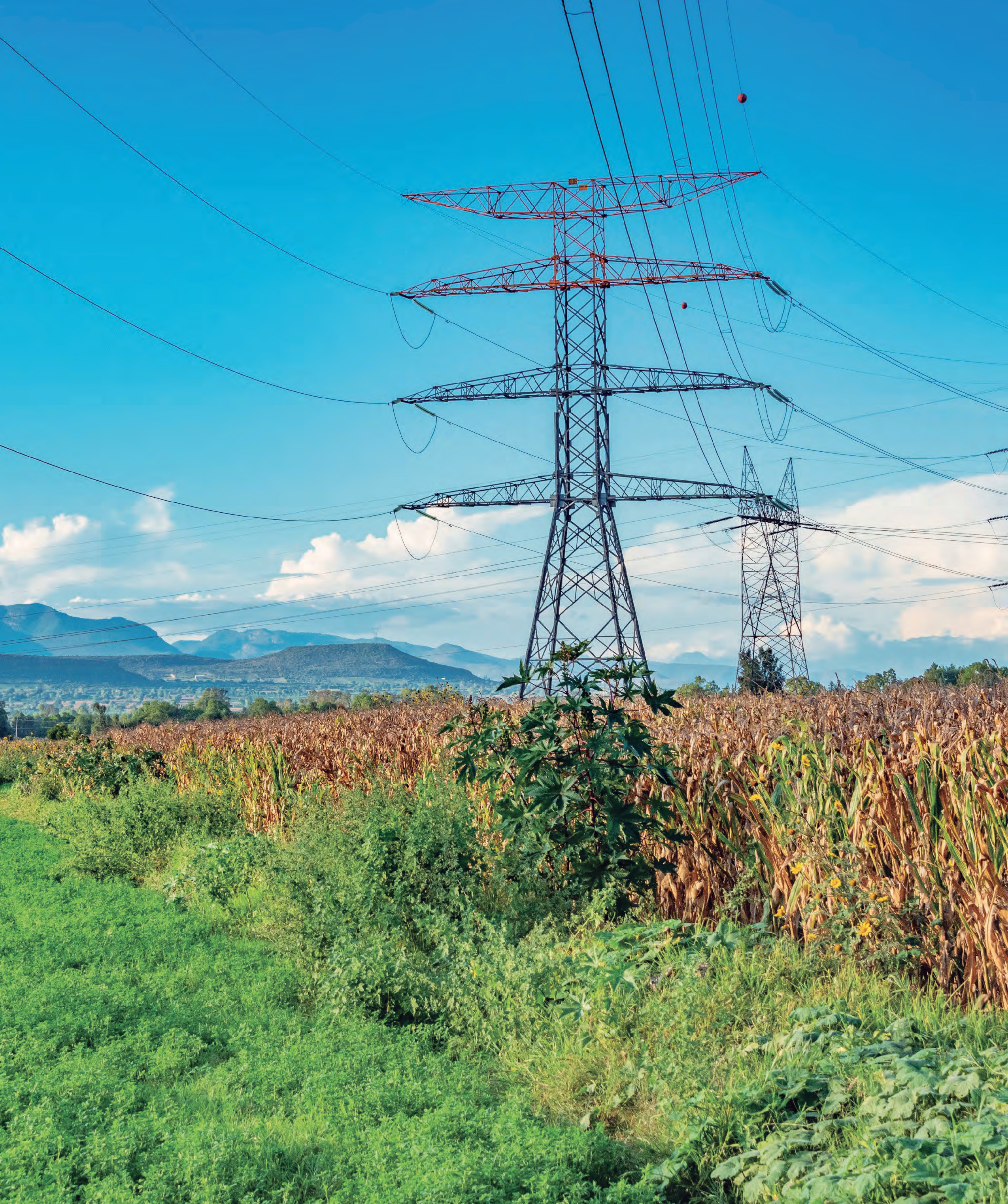
Fotografía 11. Torres de transmisión en Tula, Hidalgo. 5 de noviembre de 2020. Comisión Federal de Electricidad.
