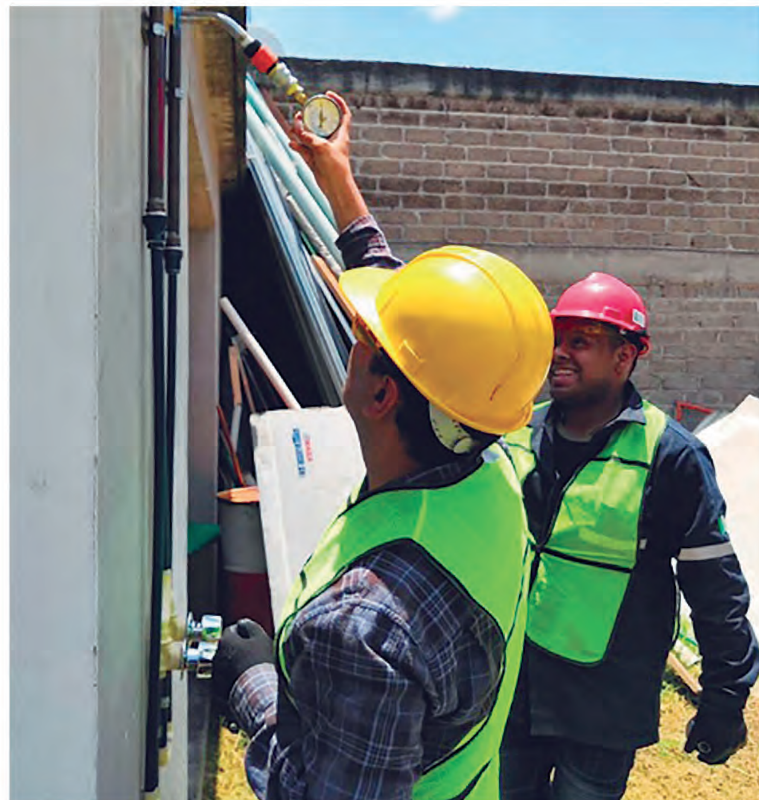
Fotografía 24. Registro de presión en la tubería de distribución de gas, previo a la instalación de un calentador. Comisión Nacional para el Uso Eficiente de la Energía.
