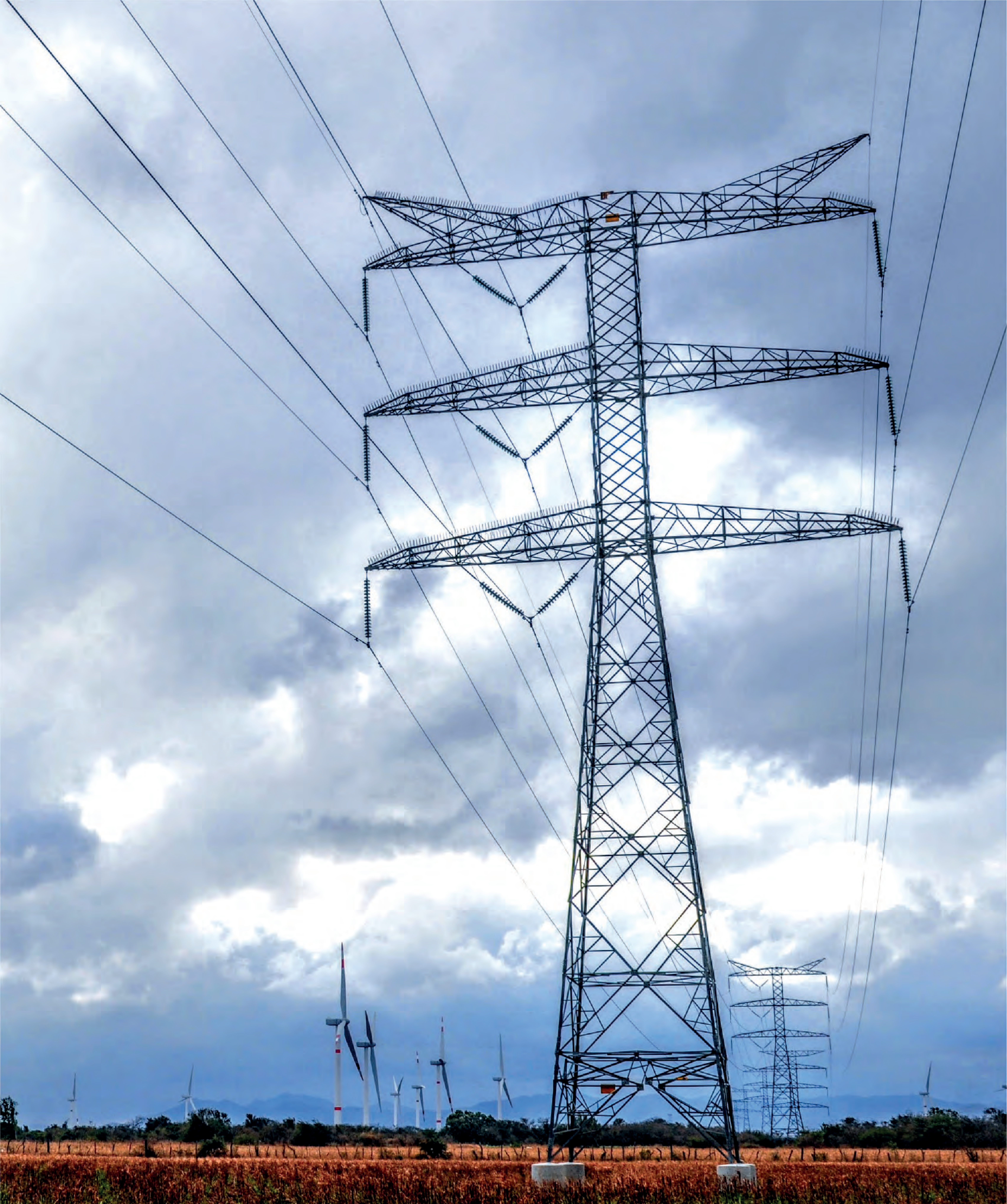
Fotografía 36. Campo Eólico La Ventosa, Juchitán de Zaragoza, Oaxaca. Comisión Federal de Electricidad.
